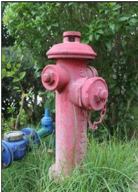
2D-6-1-5 室外消防栓
