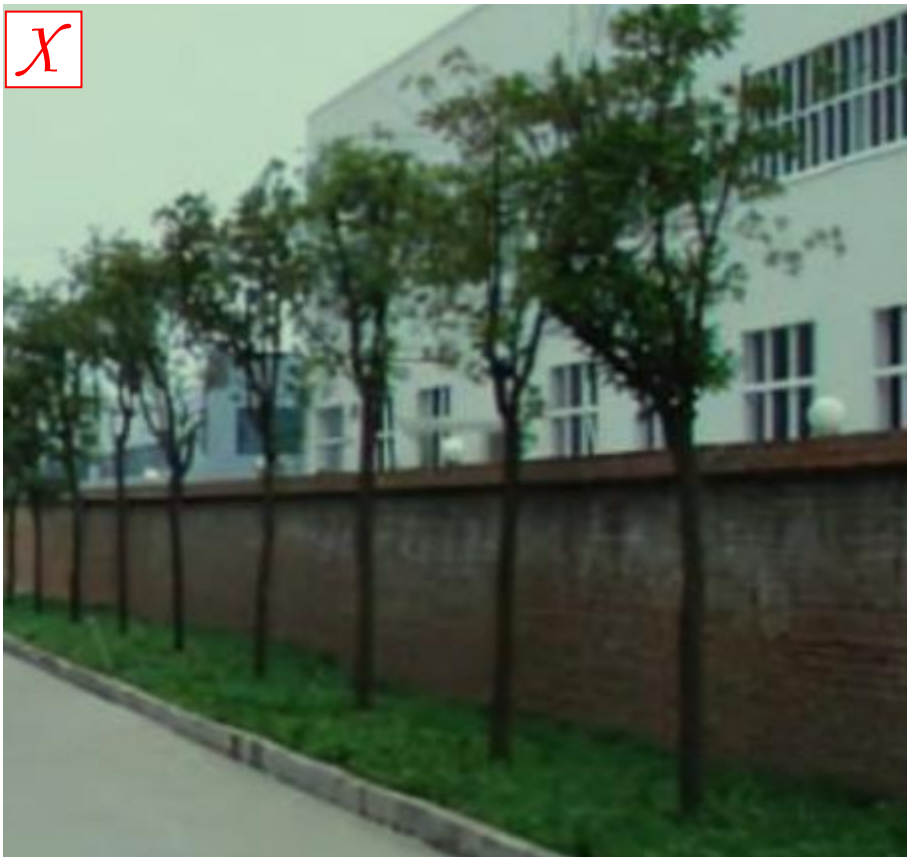
实体围墙砖墙外露，未做装饰面层
